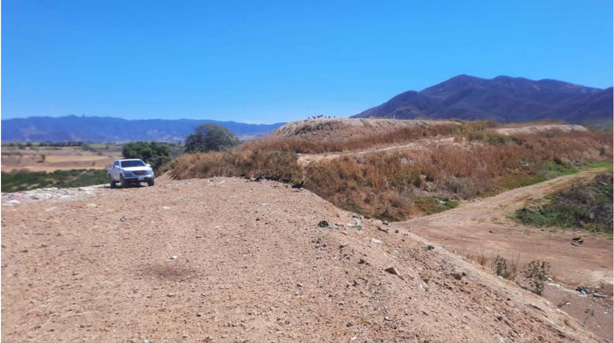
Vista panorámica de la Celda 02. Mostrando un importante avance en los trabajos de corte, nivelación, compactación y cobertura de material geológico.
